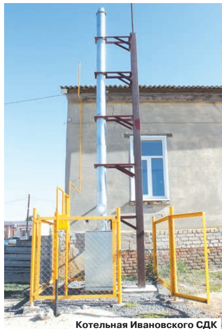
Котельная Ивановского СДК
